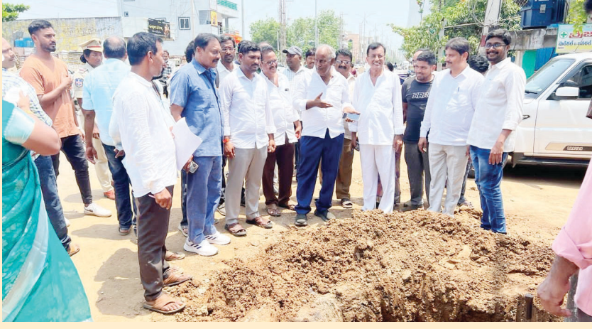
గుర్తించి స్పందించకపోవడం సరెందికాదనీ, తక్షణమే పనులు యుద్ధప్రాతిపదికన పూర్తిచేసి ప్రజల ఇబ్బందులు తొలగించి లీకేజీలను అరికట్టి నీటి సరఫరా చేయాలని ఆదేశించారు. వారం రోజుల్లో మళ్లీ క్షేత్ర స్థాయిలో పర్యటించానని, అధికారులు నిర్లక్ష్యం వహిస్తే సహించబోనని
